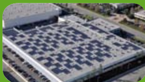
북미 QA-Lab에 설치된 태양광 패널
